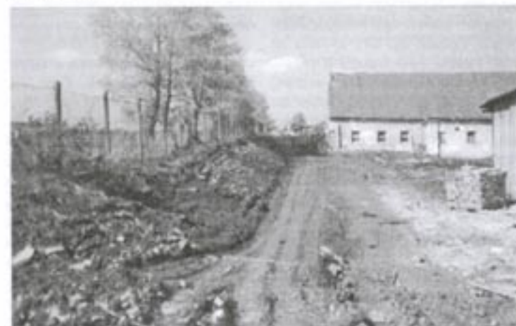
Tentýž val po odtěžení zeminy a zboření jednoho traktu dvora v roce 2000.
